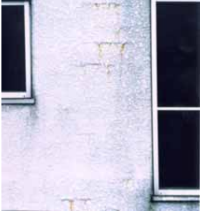
鉄筋腐食 (かぶり不足)
