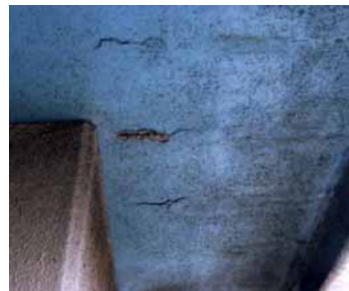
鉄筋腐食 (かぶり不足)
