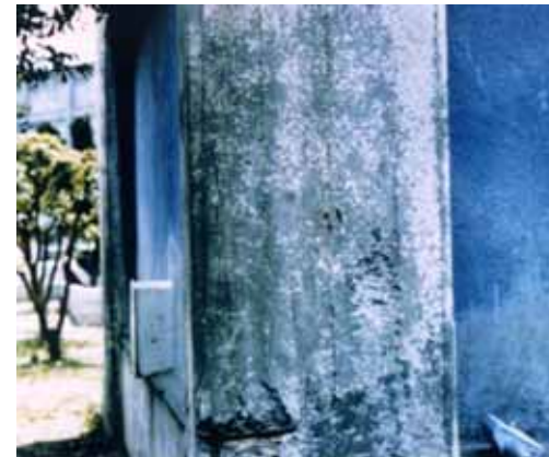
鉄筋腐食 (かぶり不足)
