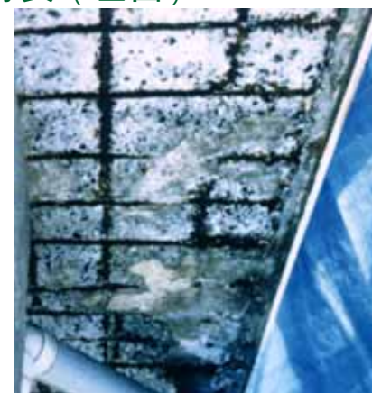
鉄筋腐食 (塩害)
