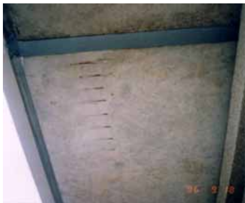
鉄筋腐食 (かぶり不足)
