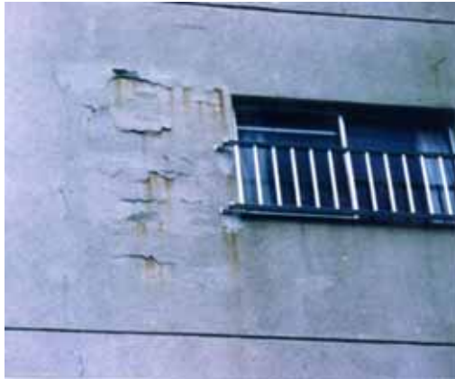
鉄筋腐食 (かぶり不足)
