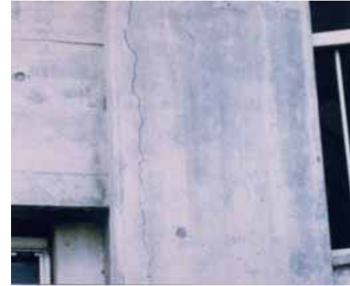
鉄筋腐食 (塩化物)
