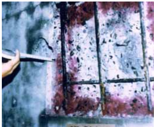
鉄筋腐食 (塩化物・中性化)
