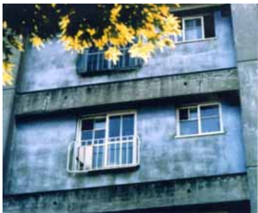
鉄筋腐食 (かぶり不足・中性化)
