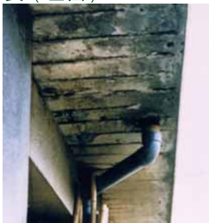
鉄筋腐食 (塩害)
