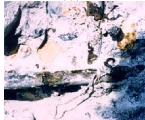
ひび割れ・鉄筋腐食
