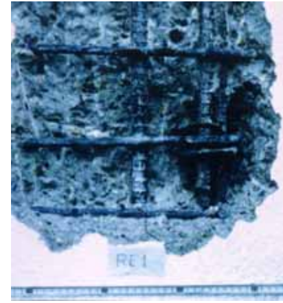
鉄筋腐食 (かぶり不足)
