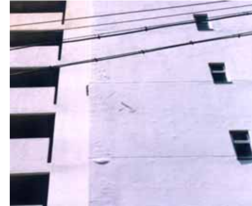
鉄筋腐食 (かぶり不足)
