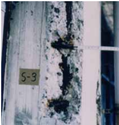
鉄筋腐食 (塩害)
