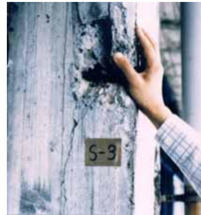
鉄筋腐食 (塩害)
