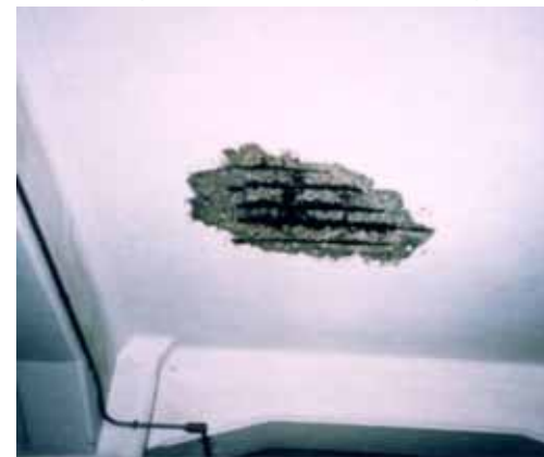
鉄筋腐食 (塩化物・中性化)
